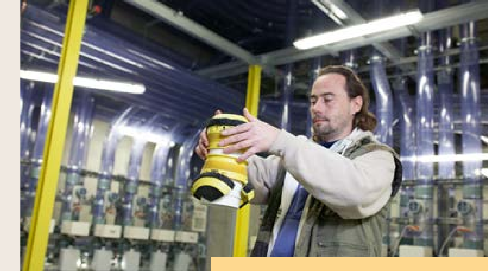
Potrubní pošta slouží nemocnici od roku 2017. Foto: archiv FN Olomouc
